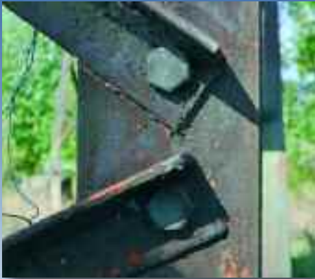
Rehabilitering med malingsprodukter vil ikke vare og er kun en utsettelse av nødvendig regalvanisering.
