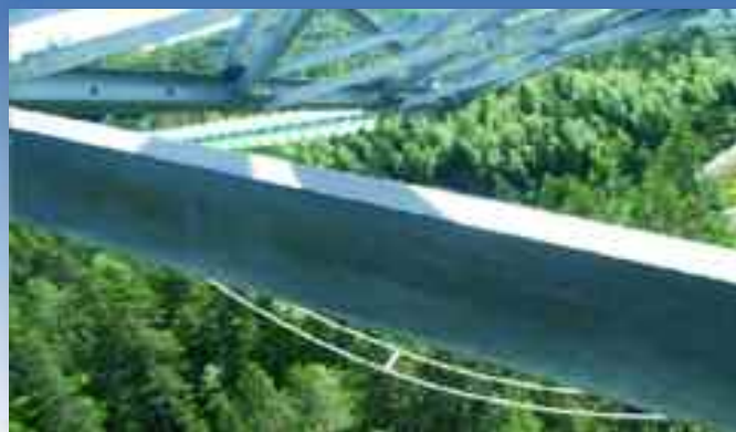
Zinganiseringen får etter hvert en blålig tone som indikerer dannelse av sinkkarbonater.
